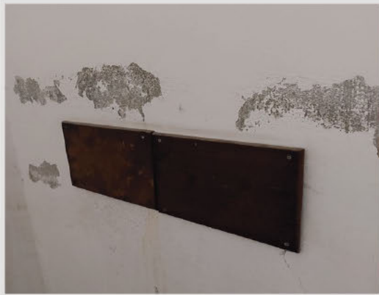
صورة #4: رطوبة حول علبة الكهرباء
