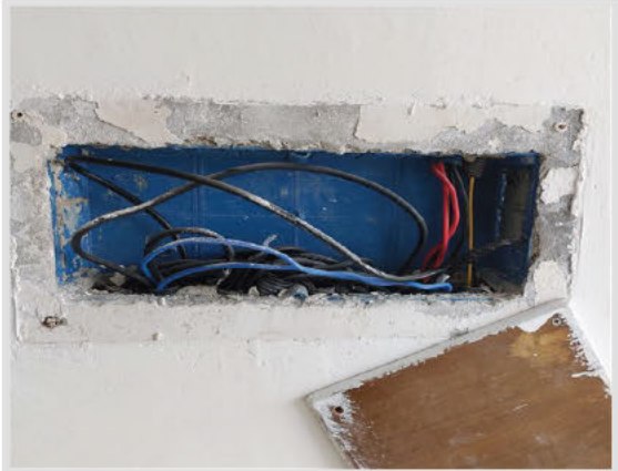
صورة #3: رطوبة حول علبة الكهرباء
